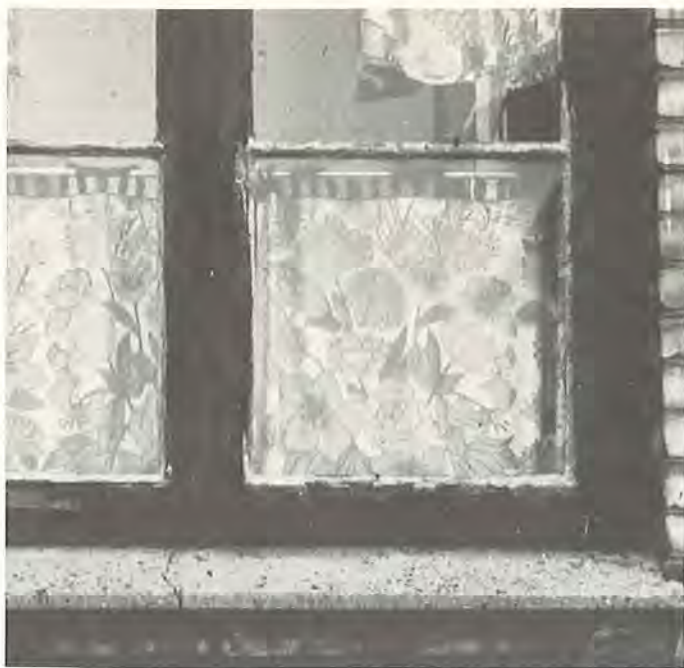
Figur 73. Vinduerne mod gården var i meget dårlig stand.
