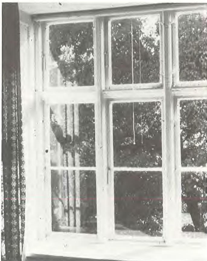
Figur 76. Oprindeligt 3-fags vindue med lysningspaneler.
